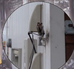
配電線から建物に雷電流が浸入した痕跡
